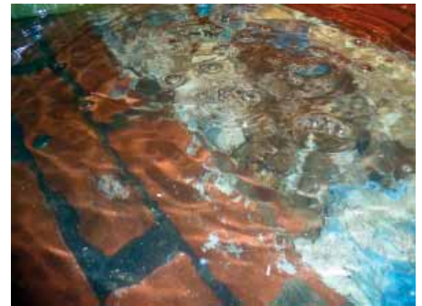
Sprudelnde Quelle im Abwasserkanal: Große Teile eines Oberflächengewässers drangen in das undichtere Bauwerk ein und belasteten die Kläranlage erheblich mit Fremdwasser.
