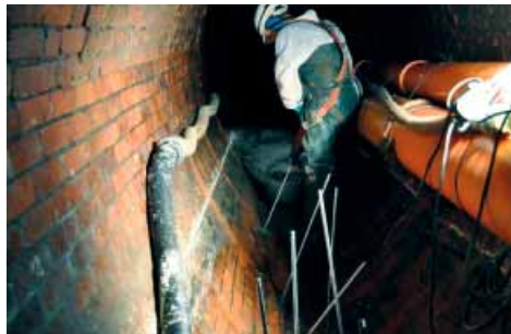
Injektionslanzen wurden bis weit hinter die Wand des Bauwerks vorgetrieben, damit das Material seine abdichtende Wirkung schon im weiteren Umfeld der undichten Wand entfalten konnte.
