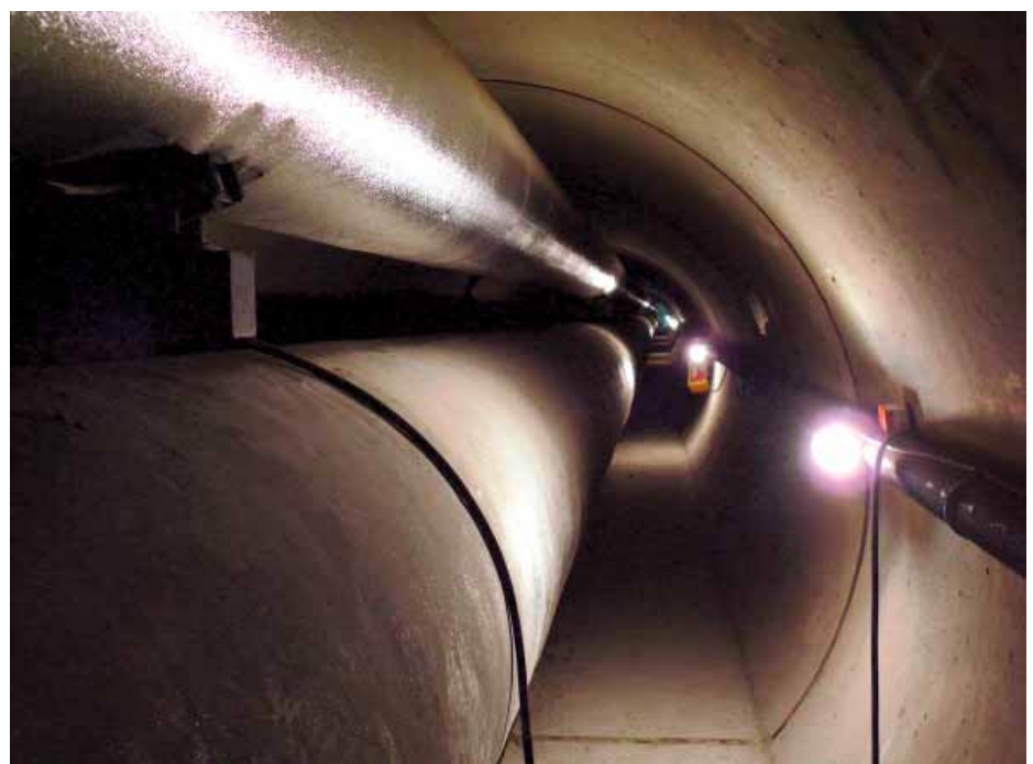
Das Fernwärmenetz der Frankfurter Innenstadt ist in solchen begehbaren Tunnelbauwerken verlegt, die teils mehrere Meter tief in Grundwasser liegen.
