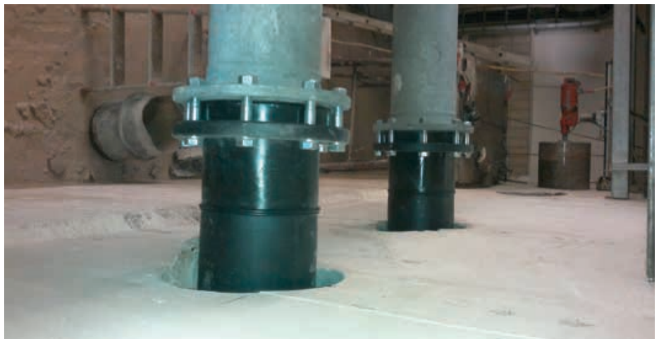
Das neue Kunststoff-Rohrnetz gehört zum Anti-Korrosions-Konzept.
