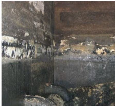
...durch drastische Schädigungsbilder im Einlaufwerk...
