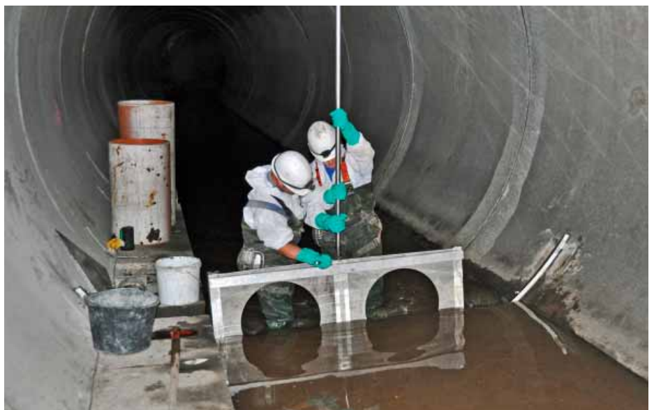
Montage des Schotts im Sammler: An die beiden Durchlässe wurden jeweils PVC-Rohre DN 500 angeschlossen, durch die der Trockenwetterabfluss des größten Essener Kanals während der Bauarbeiten abfließt.
