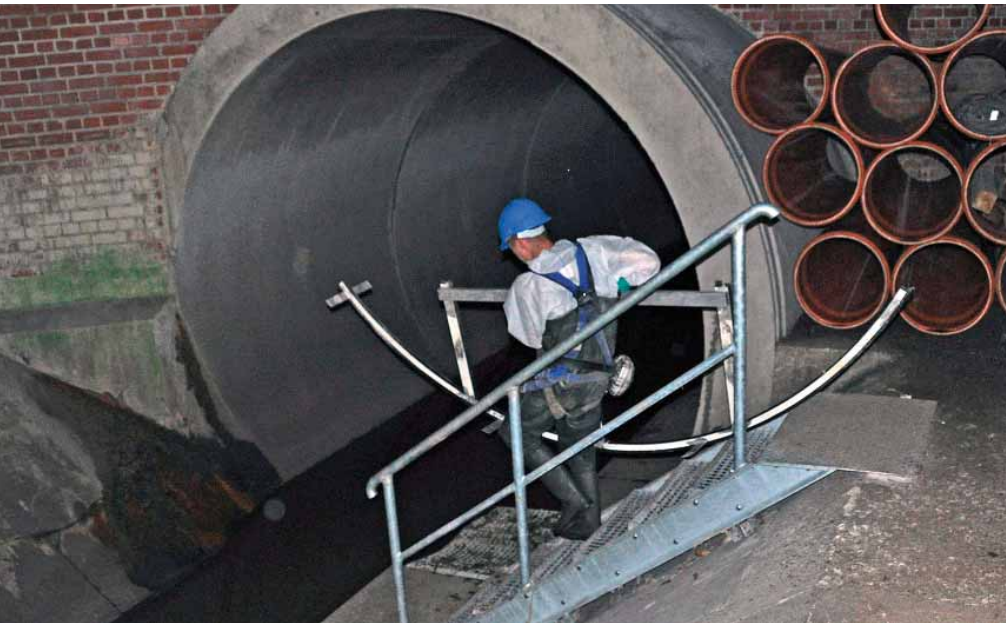
Intelligentes Leichtgewicht: Der maßgefertigte Aluminium-Rahmen der Bypass-Konstruktion lässt sich problemlos von einer Person transportieren.
