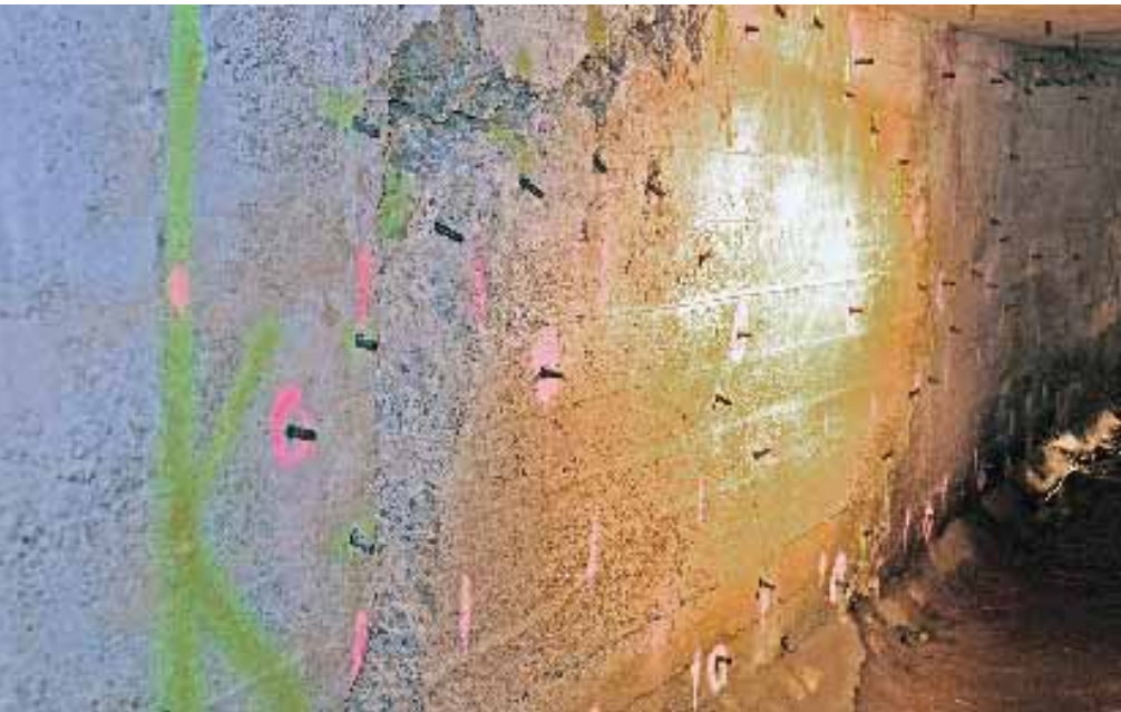
Alarmierender Bauzustand: Der Hartmann-Kanal in Duderstadt war 2010 ein akuter Sanierungsfall. Tiefe Risse mit Materialabplatzungen gefährdeten die Standsicherheit.
