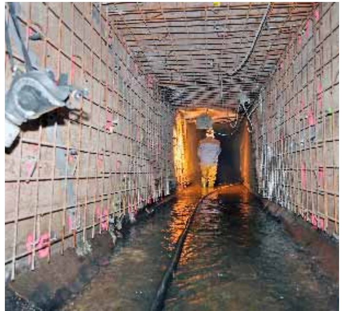
Stand sicherer Kern: An Ankern wurden ganzflächig Stahlmatten als künftige Armierung einer neuen Beton-Innenschale befestigt.
